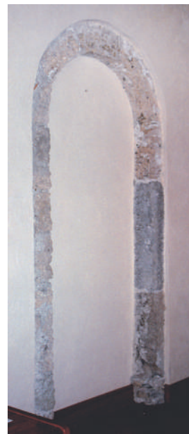
Fig. 15. Apertura ad arco a tutto sesto messa in luce nel post-terremoto (lato sud del chiostro, primo piano).
